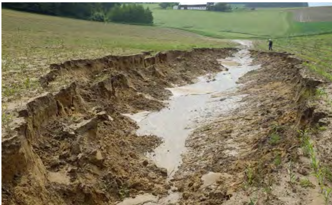
Abb. 44: Auskolkung im Talweg, Foto 03.06.2016
