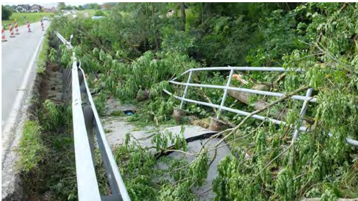
Abb. 61: Beschädigte Straße im Einzugsgebiet des Simbachs mit Einbruch des Radwegs nach Überflutung. Der Durchlass konnte die Wassermassen nicht fassen, es kam zur Überspülung der Straße von links nach rechts (Foto 03.06.2016).
