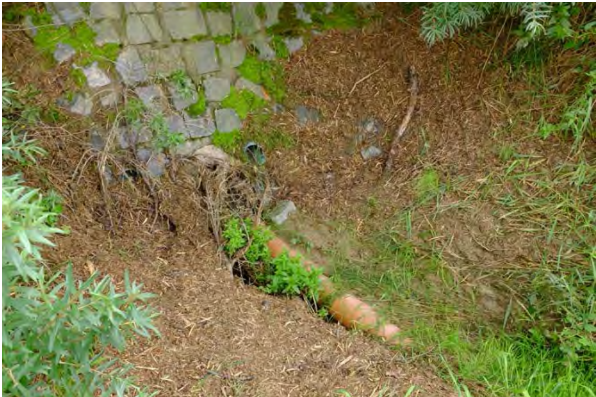
Abb. 53: Teilweise verstopfter Durchlass an der Straßenböschung, Foto 10.08.2016
